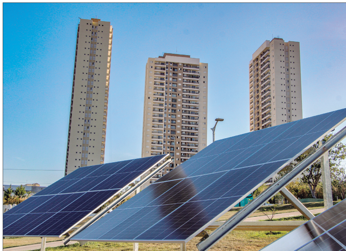
Associação projeta que potência instalada deve dobrar ainda nos primeiros meses de 2023
