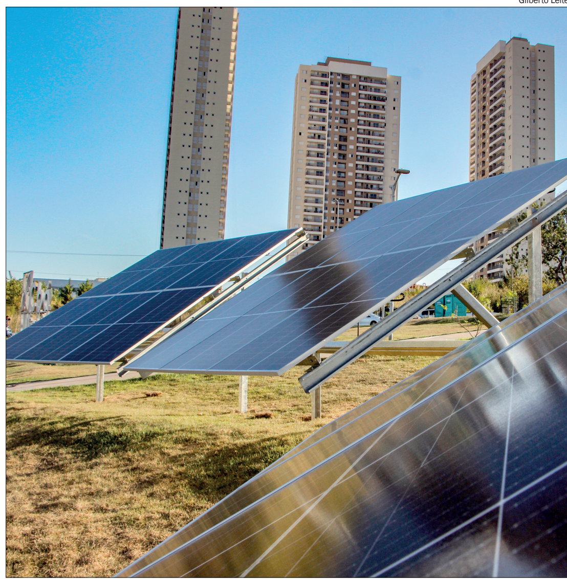
Concessionárias alegam que clientes com energia solar sobrecarregam o sistema de distribuição e precisam pagar as taxas
