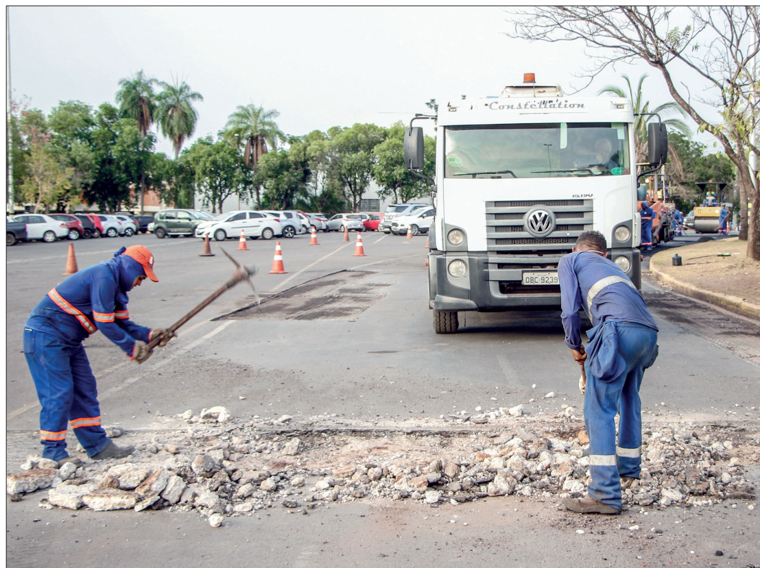
Concessionária é criticada por não recompor asfalto com a mesma qualidade após fazer obras na rede de água e esgoto
